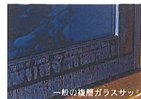
枠・障子には結露が発生しています。
